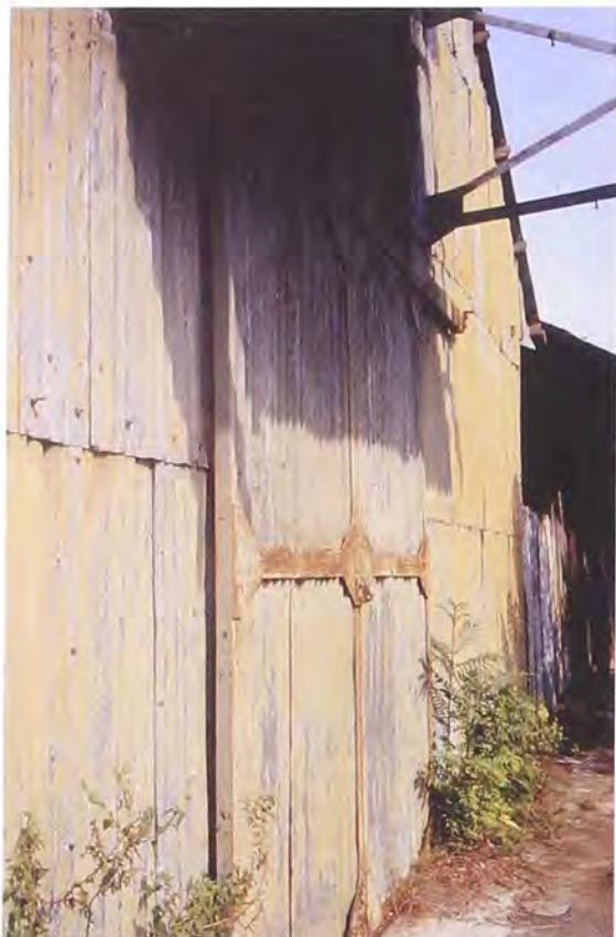
Portón de corredera en las bodegas del Cable Aéreo.
