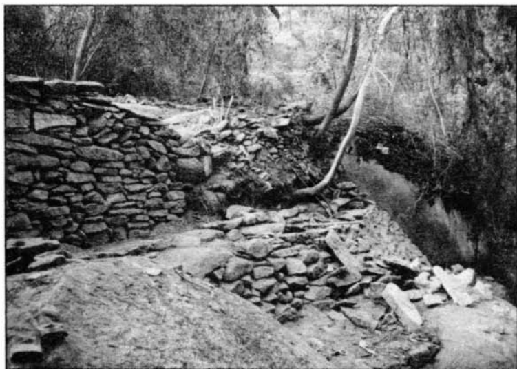
Proceso de restauración del muro de contención de la terraza de vivienda localizada sobre el costado derecho del camino principal al Cabo de San Juan de Guía.
